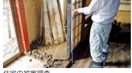
住宅の被害調査
