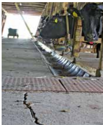
傾いた牛舎のコンクリートの床には大きな亀裂が走る
