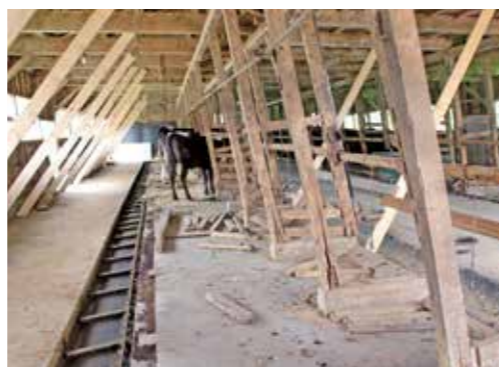
筋交いに木材を打ち付け応急的措置をした牛舎
