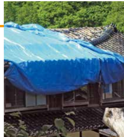
▲地震により破損した屋根
